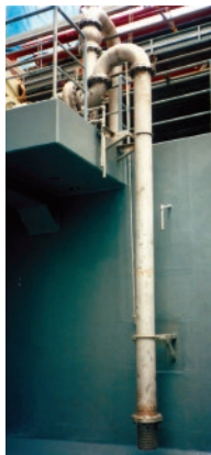
発電所の循環水洗ポンプ▶
