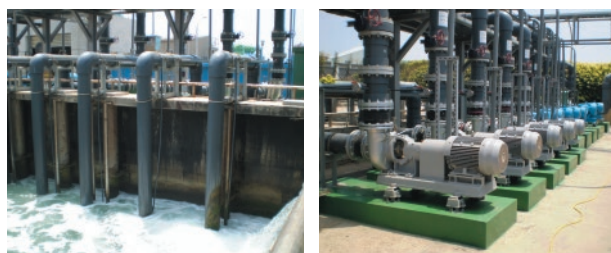
▲海水淡水化装置：海水取水ポンプ
