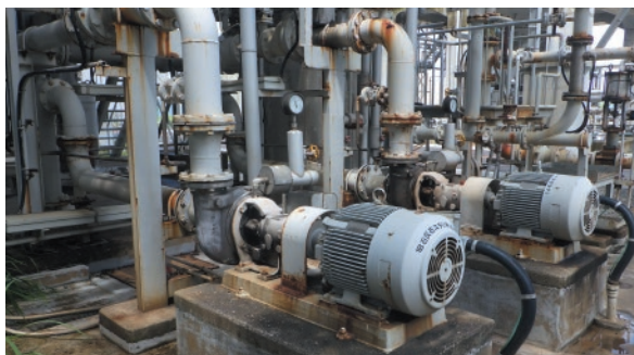
▲発電所の石灰石スラリーポンプに使われているYST合金
